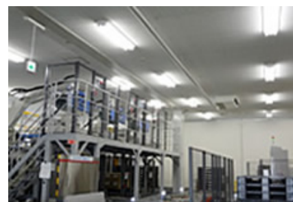
LED照明（小野工場）
