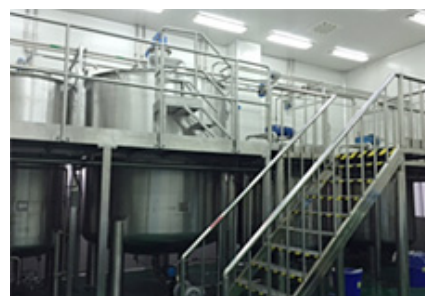
増強した設備（タンク）
