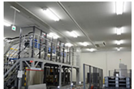
LED照明（小野工場）
