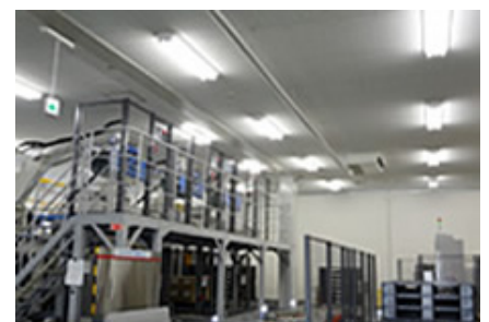
LED照明（小野工場）
