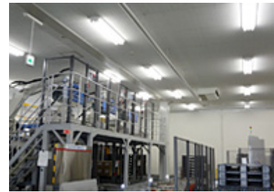
LED照明（小野工場）
