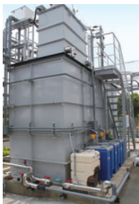
排水処理システム
