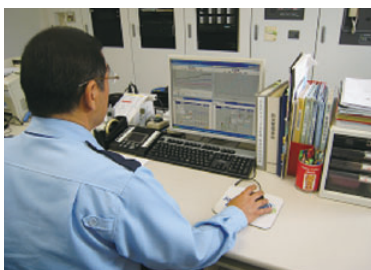
テクノパークでは電力監視モニターを導入し、施設全体の電力使用状況を監視
